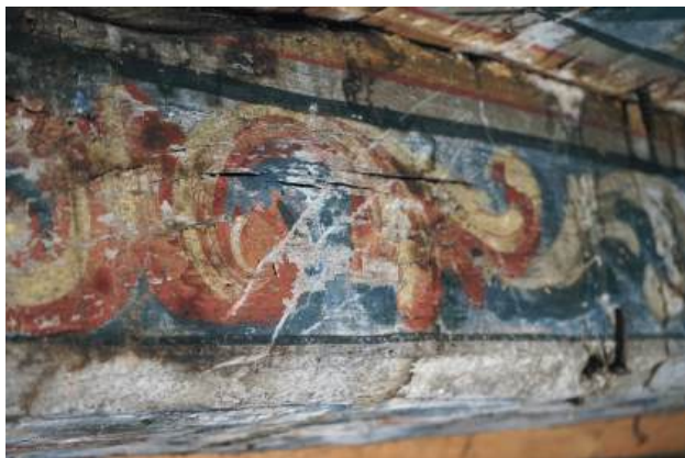
Schäden an der Malschicht durch Ausbrüche und Kratzer am Deckenbalken
