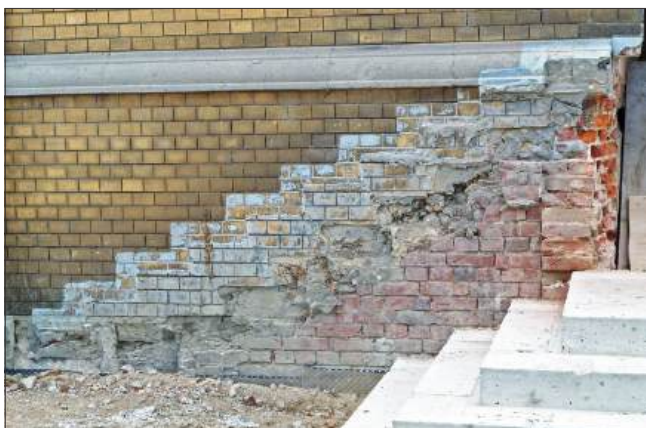
An der Wand erkennt man noch die in den Klinker eingegrabenen Stufen. Foto: Werner Preuß, Juli 2025
