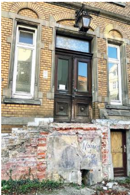
Oktober 2022: Der seitliche Treppenaufgang ist abgerissen.
