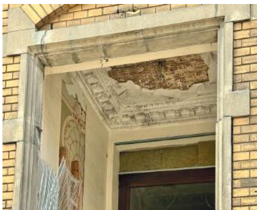
Die Stuck-Rosette im Windfang ist abgestürzt. Foto: Hajo Boldt, Juni 2025
