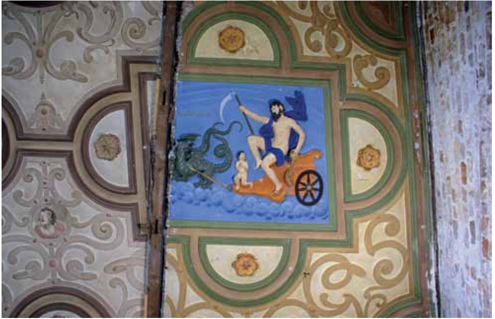
11 Das Feld des SATVRNVS im Vorzustand mit fehlenden Stuckfragmenten und entstellender Farbfassung der 1970-er Jahre.
