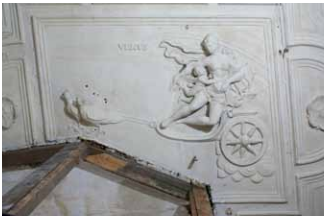
03 Der beschädigte Bereich der VENVS mit eingestellter Fachwerkwand und diversen Anstrichen in weißer Farbe, die gesamte Figur ist „zugeteigt“.
