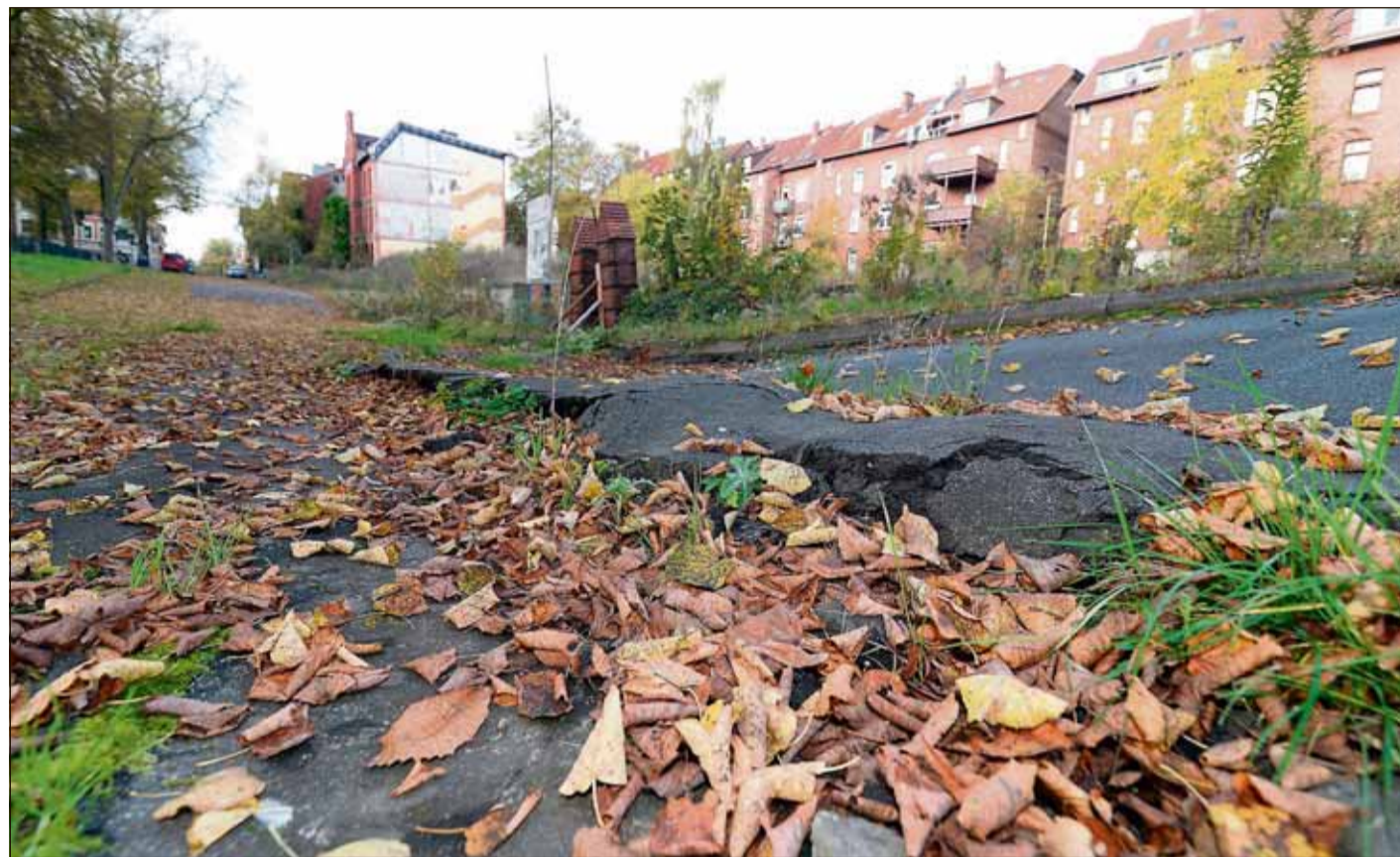
Aufgrund der Senkungsbewegungen ist die Frommestraße in einigen Bereichen tief abgesackt.
