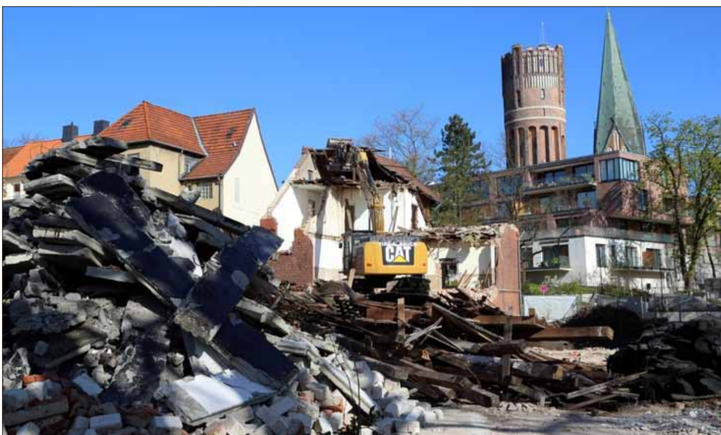
Die alte Villa Kunterbunt, sie hieß so wegen Kreidezeichnungen am Haus, ist verschwunden, sie stand nicht unter Denkmalschutz. Gegenüber dem ehemaligen Nordlandhallen-Areal entsteht ein Komplex mit 13 Eigentumswohnungen.
