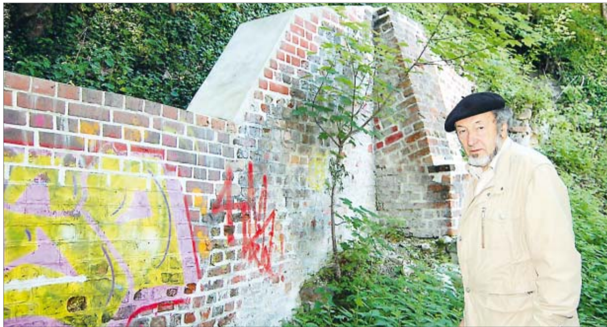
Ein uraltes Stück Lüneburg haben Curt Pomp und seine Mitstreiter gerettet, einen Mauerrest am Kalkberg. Er bedauert, dass Unbekannte die Mauer mit Graffiti verunziert haben. Foto: ca
