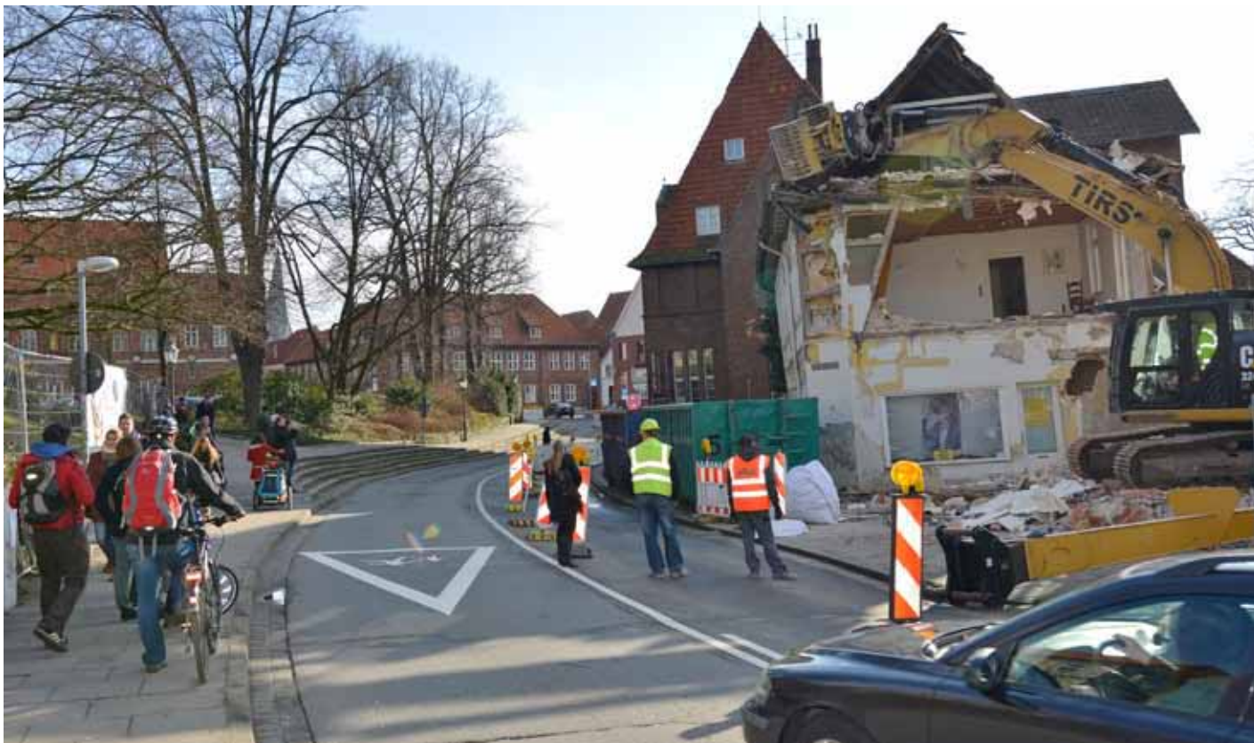
Während sich der Bagger in das Haus frisst, in dem ein Friseurgeschäft untergebracht war, läuft der Verkehr auf der Egersdorffstraße weiter. Foto: be
