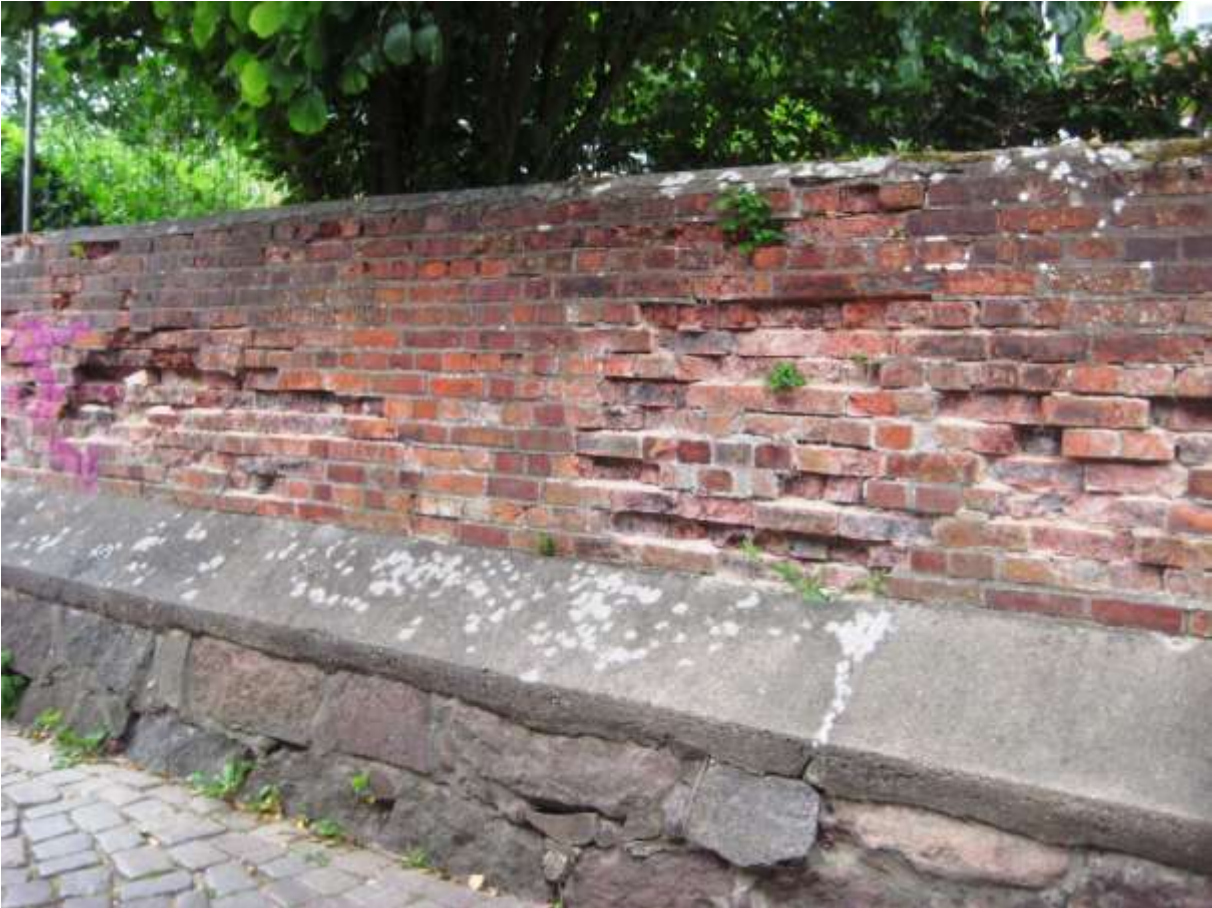
Zustand der Mauer Am Sülzwall 2015. Unten der alte Natursteinsockel
