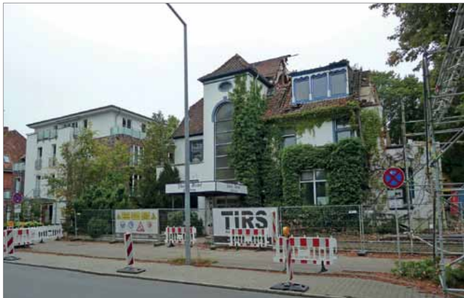
Das „Parkhotel“ während des Abrisses. Links daneben an Stelle der „Heiderose“ eine Stadtvilla, wie tausend andere. Foto: Preuß
