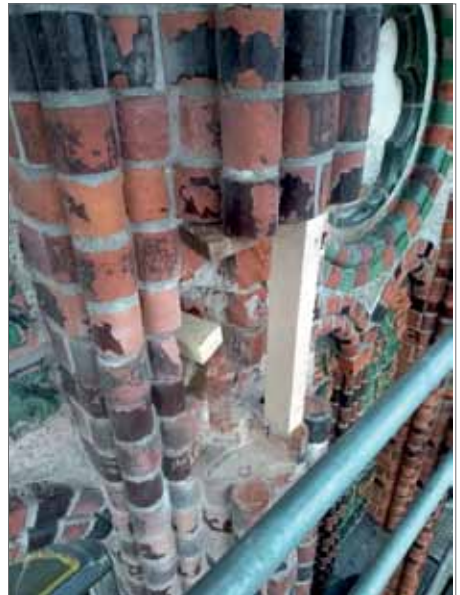
Sanierung des Tragwerks und der Formsteine des Schmuckgiebels. Foto- dokumentation der Restauratoren
