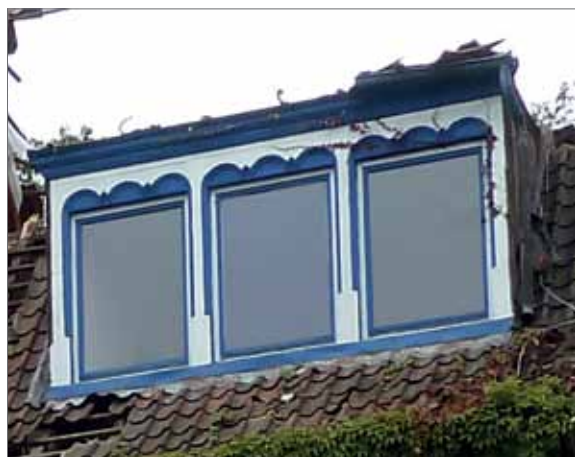
Das Parkhotel im Abriss. Die „Schabrackenfenster“ sind originell und in Lüneburg wohl nicht zum zweiten Mal zu finden, der Anstrich war dagegen zuletzt „knallig“ durch den scharfen Kontrast. Foto: Preuß
