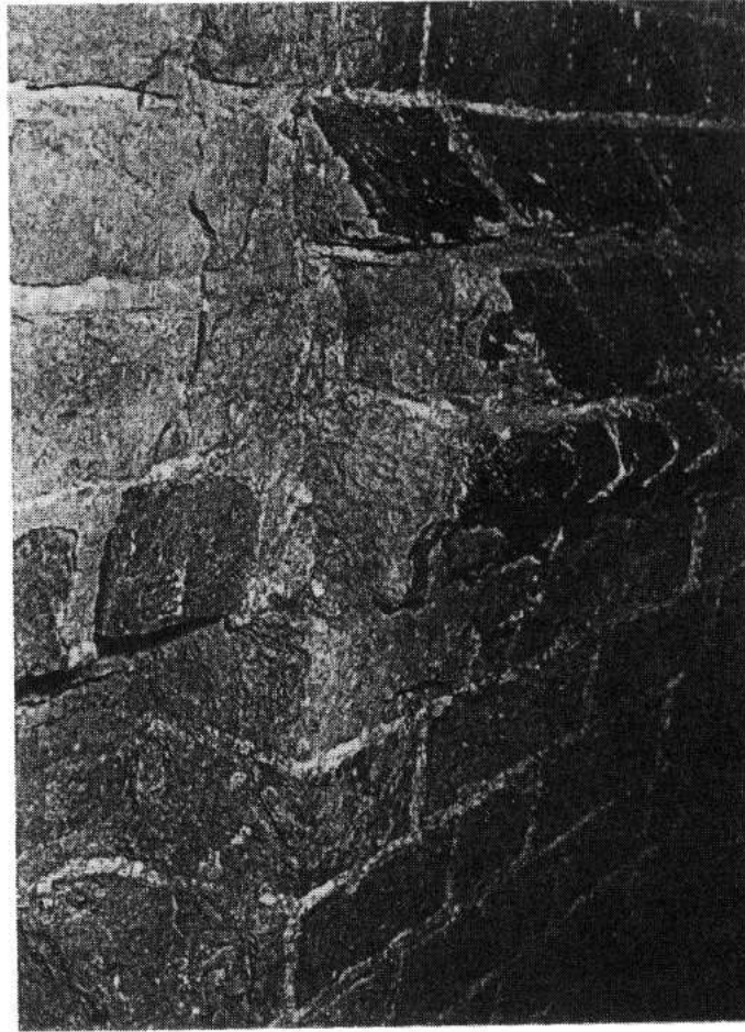
Freigelegtes Kaffgesims an der ehemaligen westlichen Außenwand später von den Gewölben der Turmseitenkapellen verdeckt.
